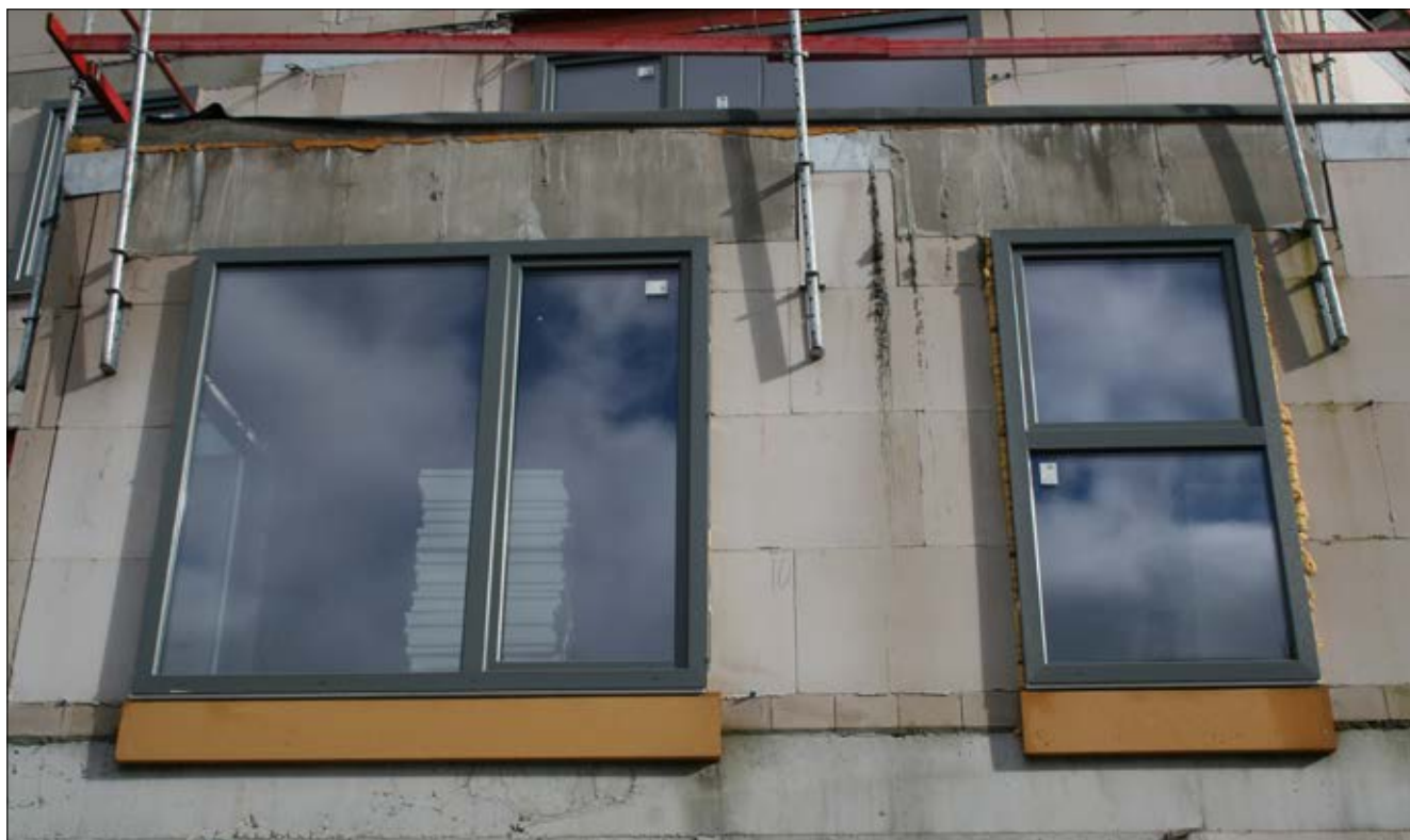
CHÂSSIS – Ils sont alignés dans l'épaisseur d'isolant, pour éviter les ponts thermiques.
