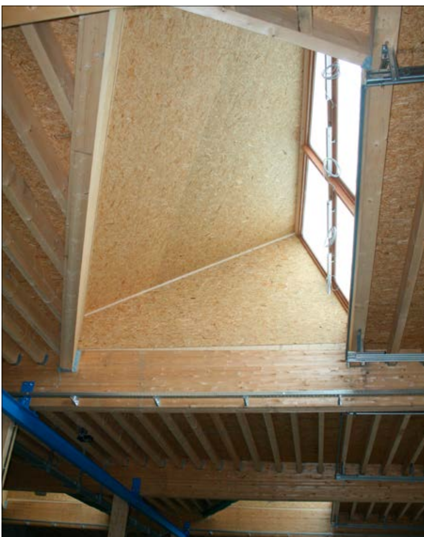
LANTERNEAUX – La toiture des halls de stockage est équipée de six lanterneaux qui font office de puits de lumière et serviront de zone de démonstrations photovoltaïques.
