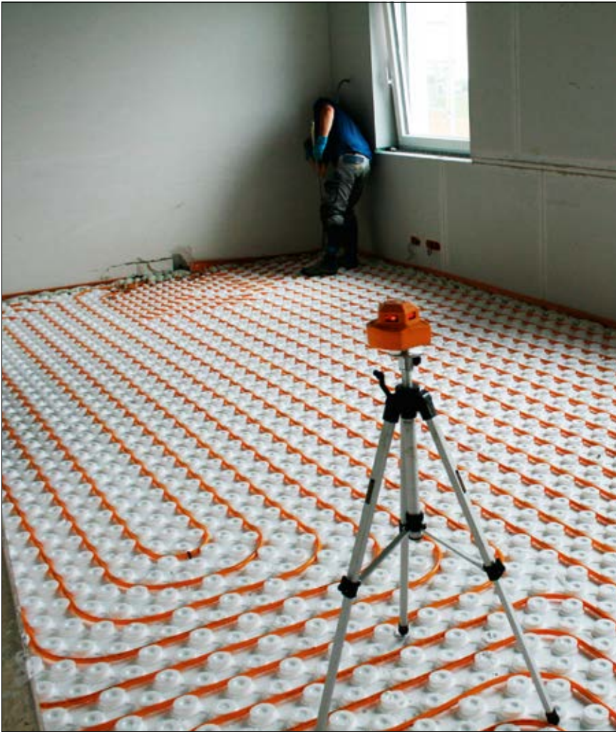
CHAUFFAGE PAR LE SOL – Le réseau est alimenté par deux pompes à chaleur, dont une pompe sol/eau composée d'un réservoir de glace et de tubes absorbeurs d'énergie solaire installés en toiture.
