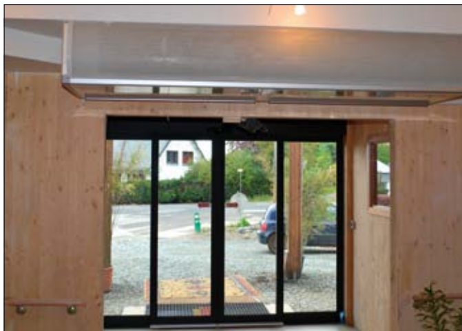
TEMPÉRATURE STABLE – Afin d'éviter des écarts de température, un rideau d'air chaud a été installé à l'entrée principale.
