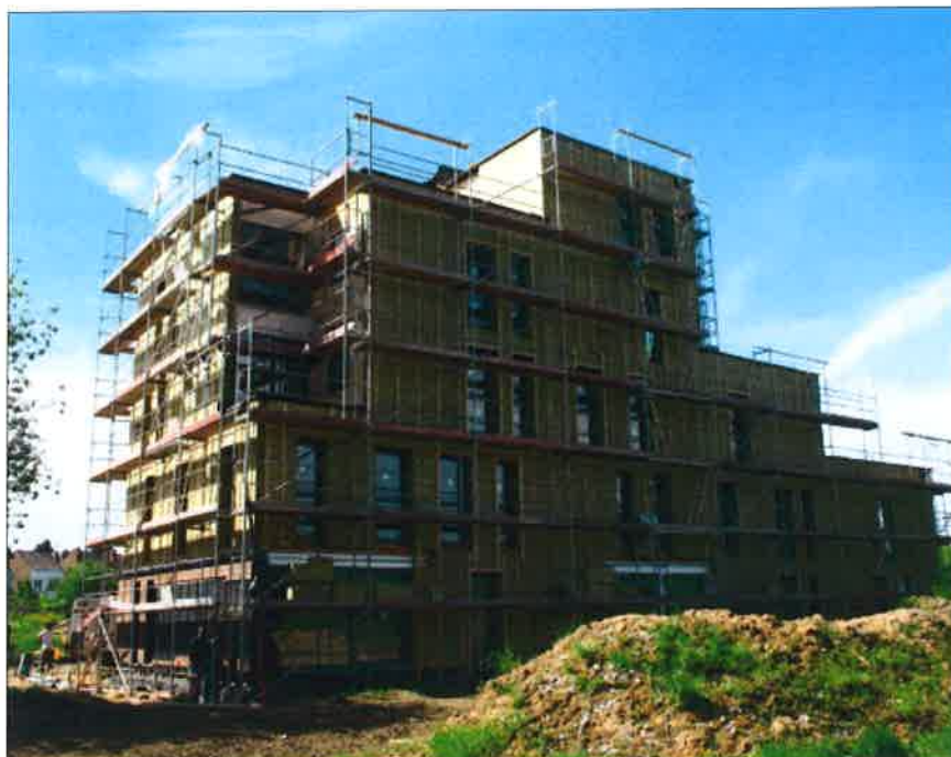
ECCOQUARTIER – La structure du premier immeuble, sur les cinq prévus à terme sur le site des Closières, a été érigée en à peine 22 jours.
